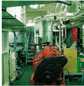
غرفة المحرك ghurfat al-muHarrik engine room
